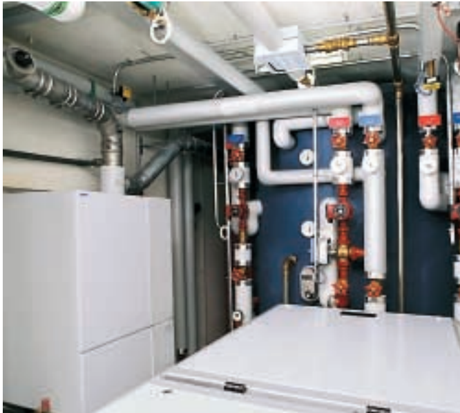
Die Spitzendeckung übernimmt ein modulierender 60 kW-Gas-Kondensationskessel (links)
