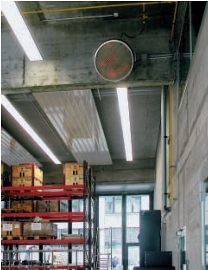
Gas-Katalyt-Strahler beheizen einen Teil der Lagerräume; der Rest – insbesondere wo Laufkatzen nicht direkt erhitzt werden sollten – wird mit Deckenstrahlplatten erwärmt
