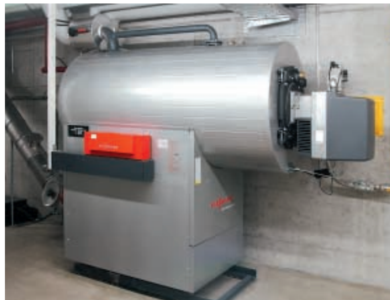
Der 500 kW-Kondensationskessel mit modulierendem Gas-Gebläsebrenner
