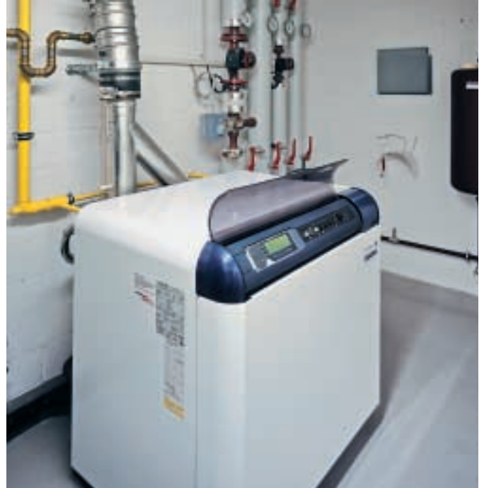
Der modulierende 80 kW-Gas-Kondensationskessel braucht wenig Platz
