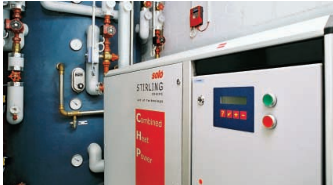
Das Stirling-BHKW vorn, hinten der 2000 l-Speicher mit integriertem Wassererwärmer
